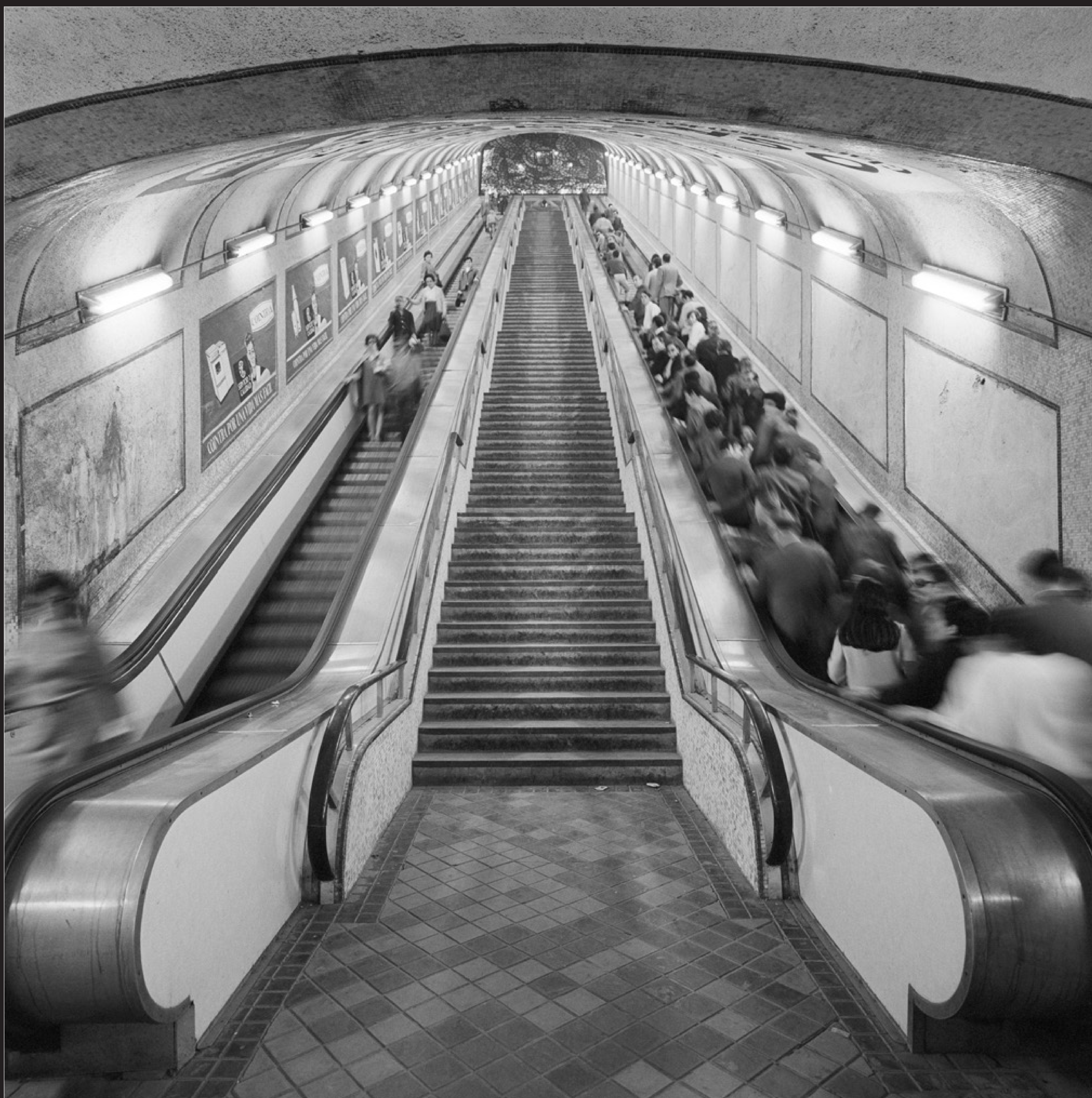
Escaleras mecánicas de la estación de Plaza de España. Originalmente construidas en un solo tramo que fue sustituido por dos tramos para facilitar su mantenimiento en 1982 (circa 1970).
