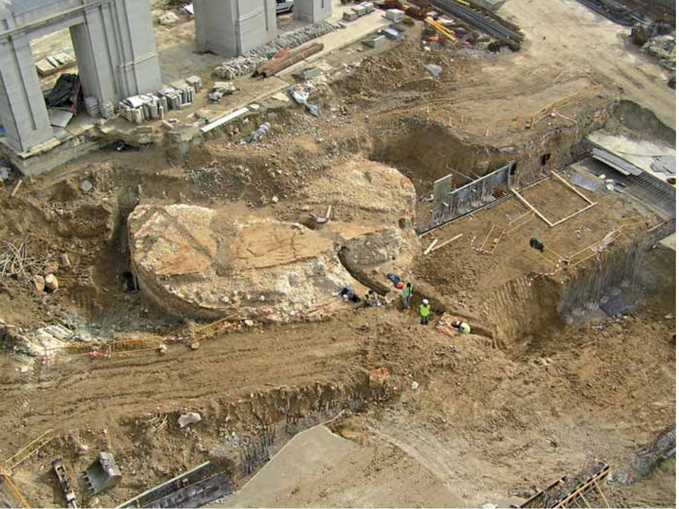
Restos arqueológicos de la cimentación de la Fuente de los Mascarones en las obras del Intercambiador de Príncipe Pío Archaeological remains of the foundations of the Mascarones Fountain uncovered during construction of the Príncipe Pío transport interchange station
