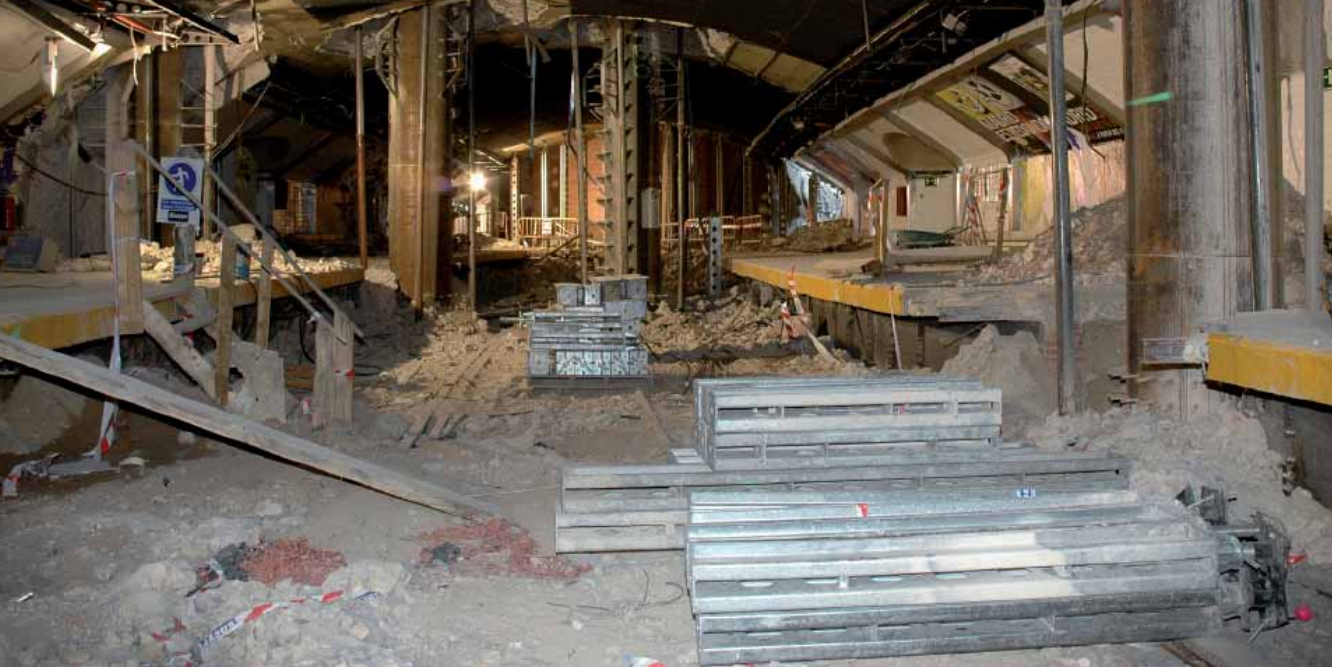
Obras en antigua estación línea 3. Septiembre 2006 / Work on the old Metro line 3 station. September 2006
