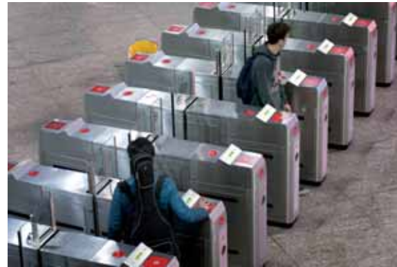
Batería de torniquetes de acceso a Cercanías.
